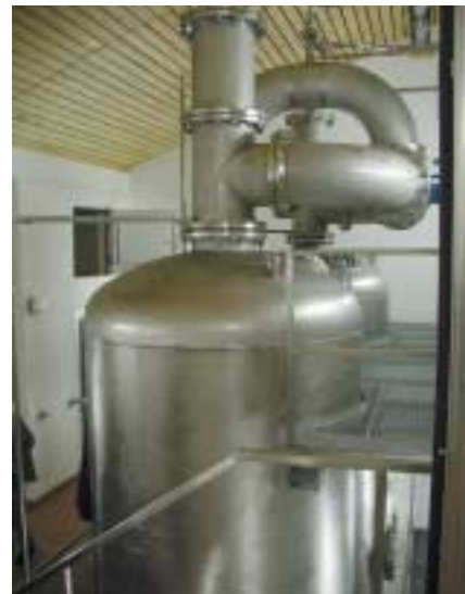
Nichtrostender Stahl im Wasserwerk Würzburg-Estenfeld
