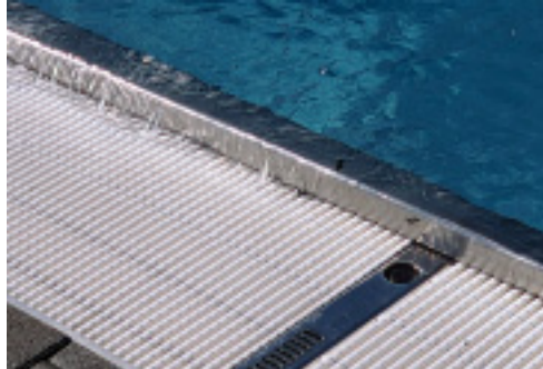
Über die Überlaufrinnen wird das Beckenwasser in den Schwallwasserbehälter zurückgeführt.
