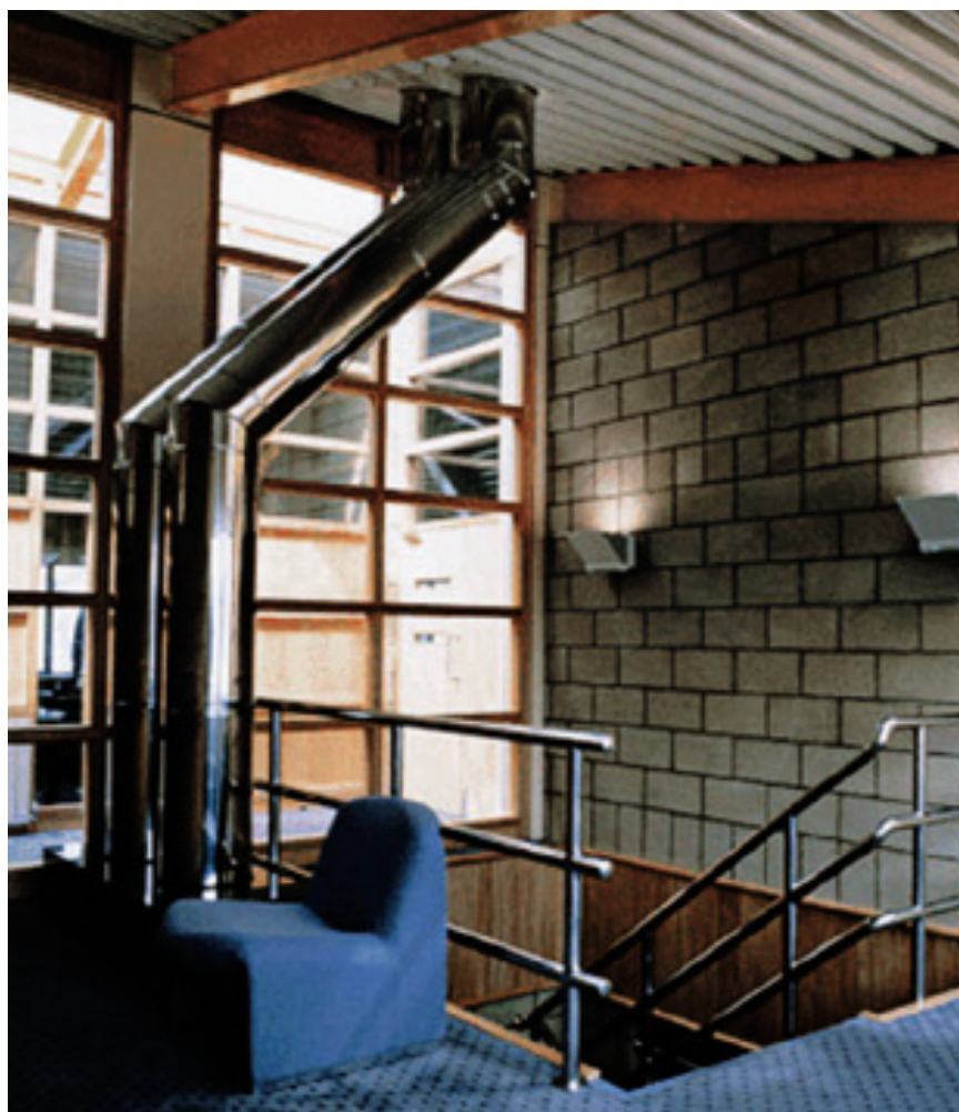
Bild 3: Abgasanlage aus Edelstahl Rostfrei in einem Innenraum – auch ein dekoratives Element
