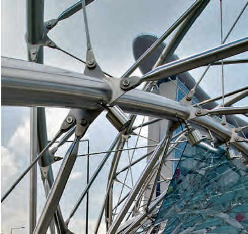
Die Spiralrohre sind durch Zug- und Druckstäbe miteinander verbunden.
