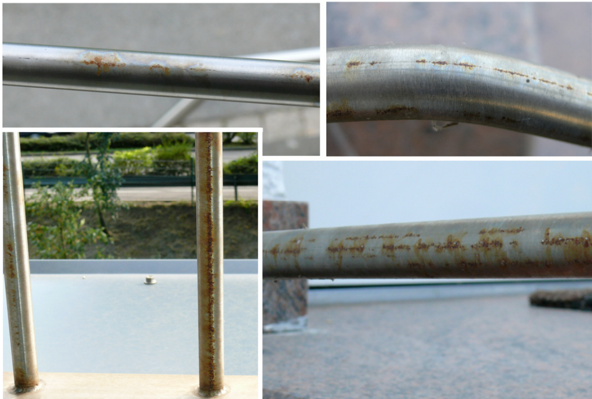
Beispiele zu den linienförmigen Korrosionserscheinungen an Stabmaterial
