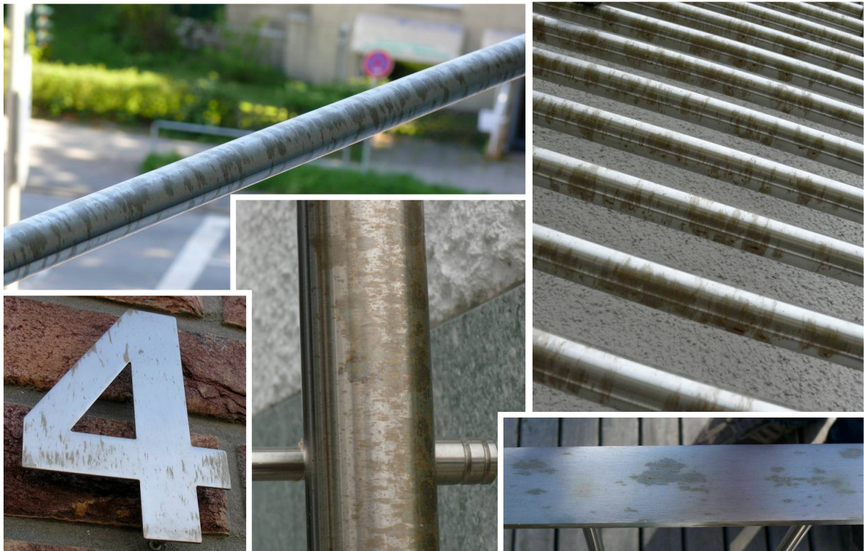
Beispiele zu den unregelmäßigen Verfleckungen an Rohr-, Stab- und Flachmaterial
