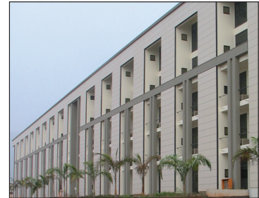
▲ Senate Block in Abuja. Die T-Elemente und die Plattenelemente (Verbindungen zwischen den T-Elementen) werden von Modersohn-Ankern gehalten. Bild: 31c90685.tif
