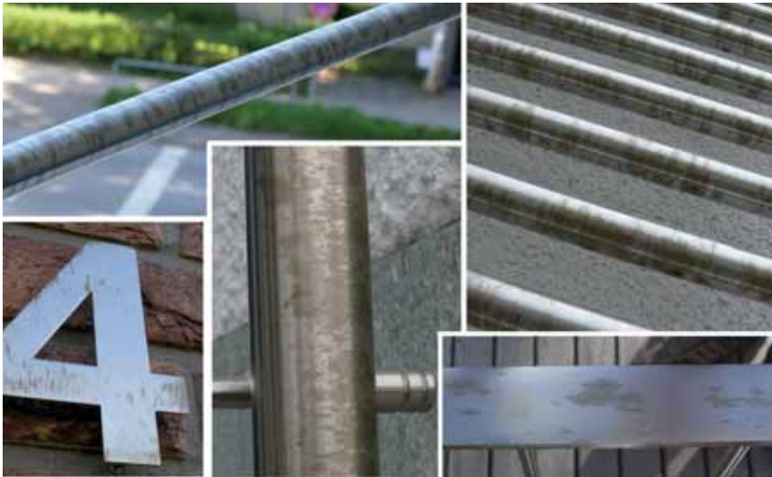
Beispiele zu den unregelmäßigen Verfleckungen an Rohr-, Stab- und Flachmaterial.
