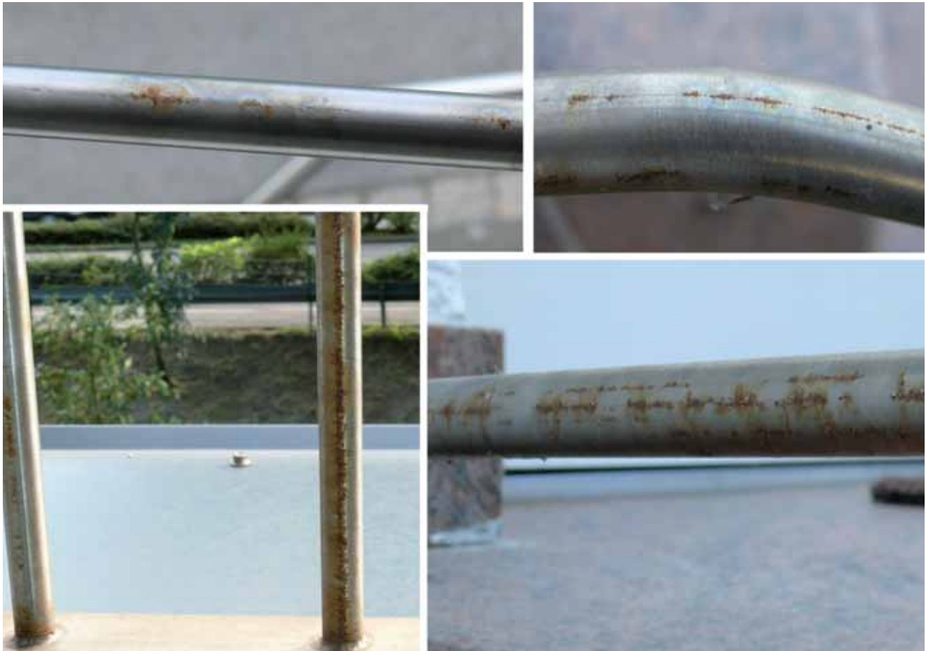
Beispiele zu den linienförmigen Korrosionserscheinungen an Stabmaterial.
