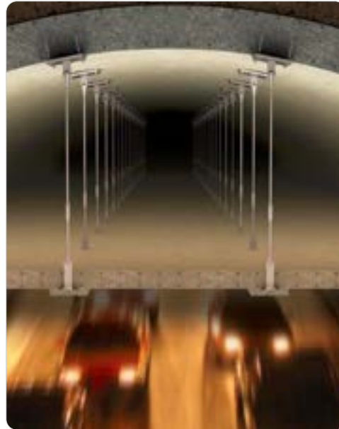
Deckenabhängungen in einem Straßentunnel Foto: Ancon
