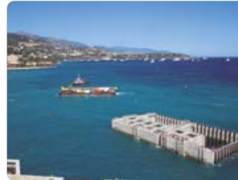
Stadterweiterung ins Meer hinein, Monaco
