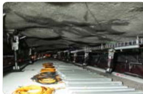
Dynamische Abhängungen im Eisenbahntunnel Holmestrand, Foto: Sandvik Materials Technology
