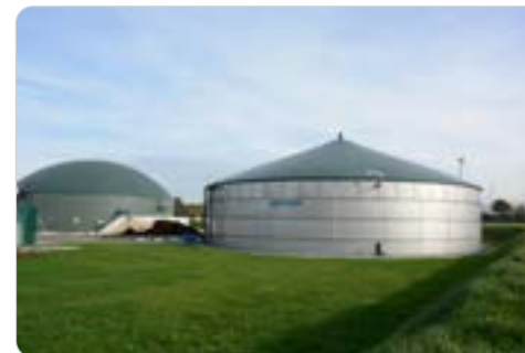
Biogas-Tank aus nichtrostendem Stahl
