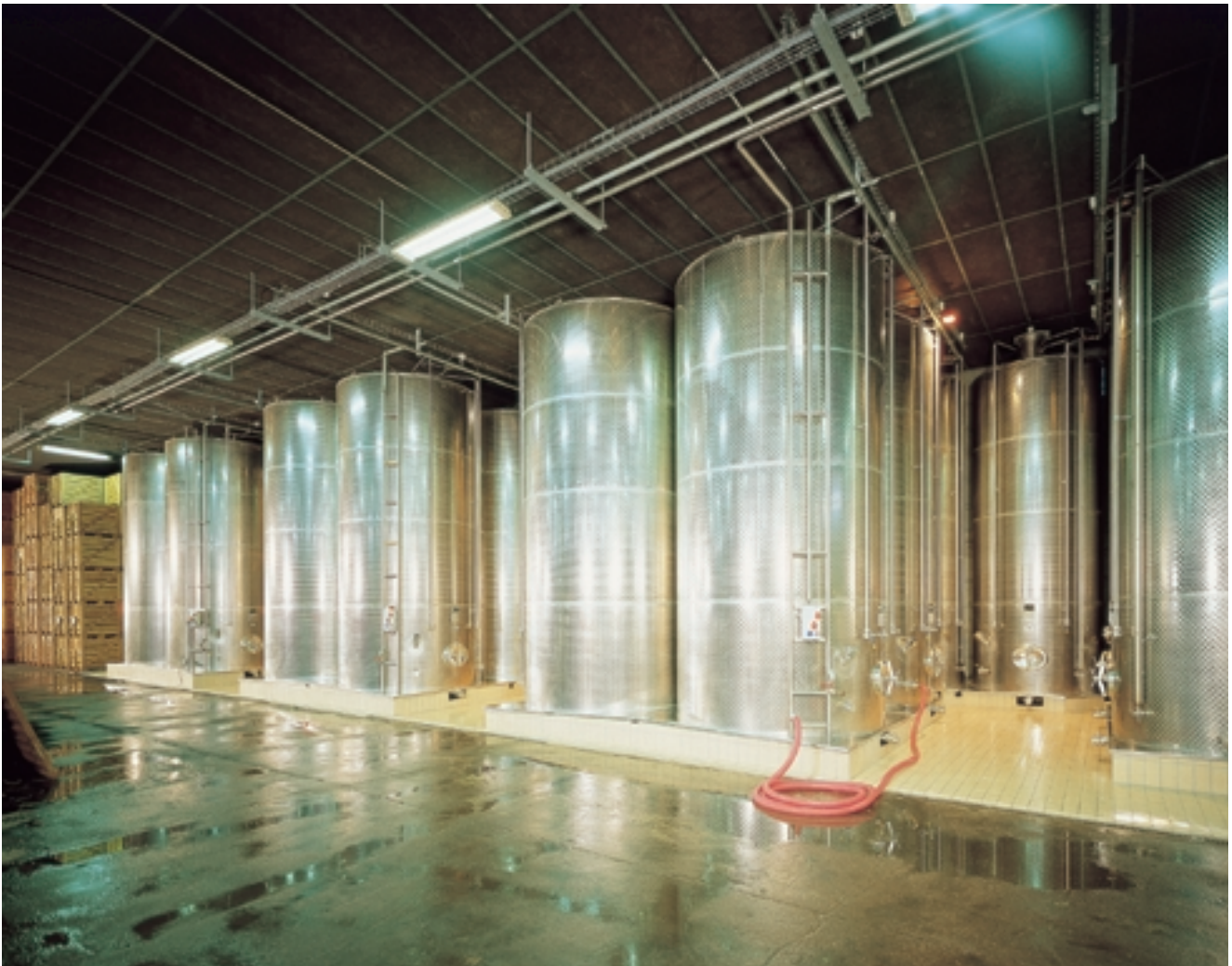
Bild 3: Die Tanks dieser Anlage wurden aus Edelstahl Rostfrei, Oberflächenausführung 2R, gefertigt, innen hochglanzpoliert und außen rund geschliffen (d.h. marmoriert).
