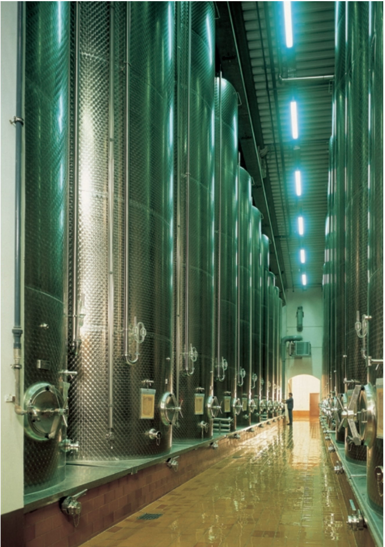
Bild 2: In stehenden, zylindrischen Tanks aus Edelstahl Rostfrei können jeweils bis zu 200.000 Liter Wein gelagert werden.
